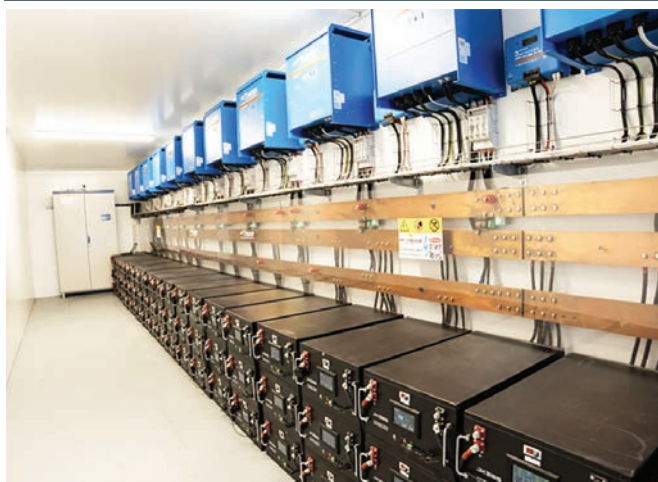
Fot. 2. Praktyczne zastosowanie: 1,3 MWh zmagazynowane w niskonapięciowych akumulatorach LiFePO4 48 V ( www.victronenergy.com )
