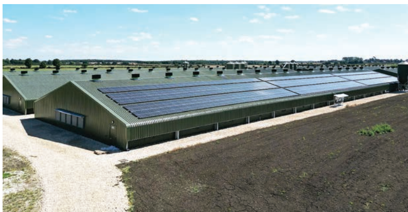
Fot. 1. Panele PV stają się ważną częścią nowoczesnych budynków inwentarskich ( www.westwood-energy.co.uk )
